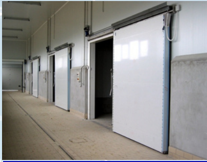
CORREDERA LACADAS. AUTOMATISMO ELÉCTRICO
